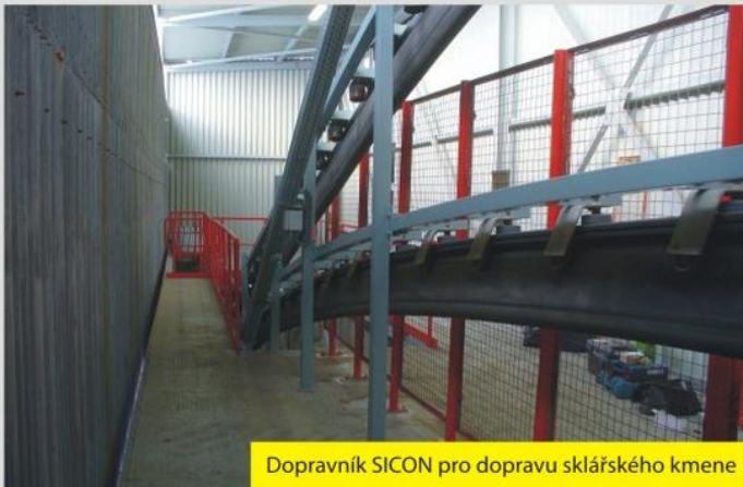
Shazovací vůz na skládce stabilizátu v elektrárně
